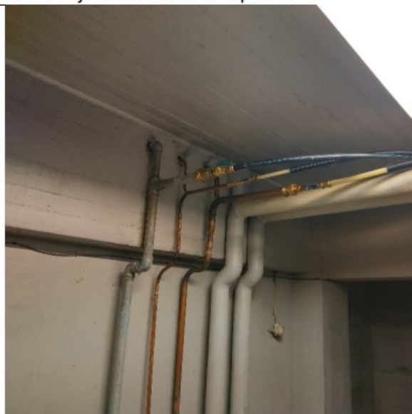
Autohallin väliaikaisia muoviputkia
