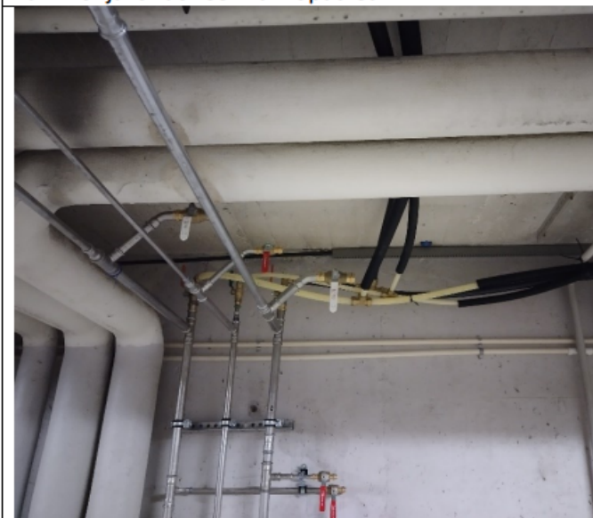
Autohallin väliaikaisia muoviputkia
